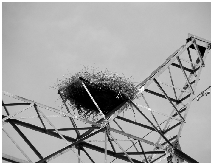
Рис.5 Металлическая платформа, установленная на опоре высоковольтной ЛЭП для гнездования аистов
